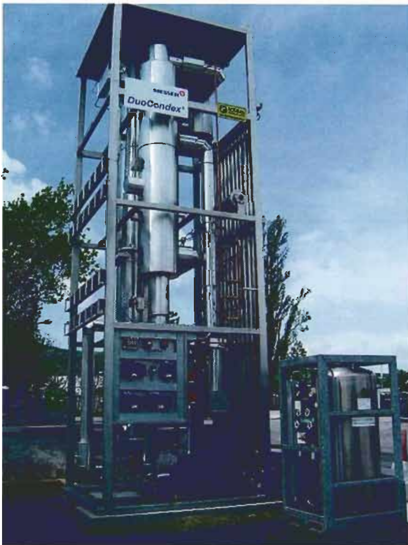
Bild 7: DuoCondex® -Pilotanlage im Testbetrieb
