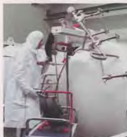
Rohrleitungen, zum Beispiel an Behältern, werden mit Schweißautomaten weitgehend orbital verschweißt. Diese Technik ist eine Spezialität unserer französischen Tochtergesellschaft Polysoude. Sie kann auch in Reinräumen angewendet werden
