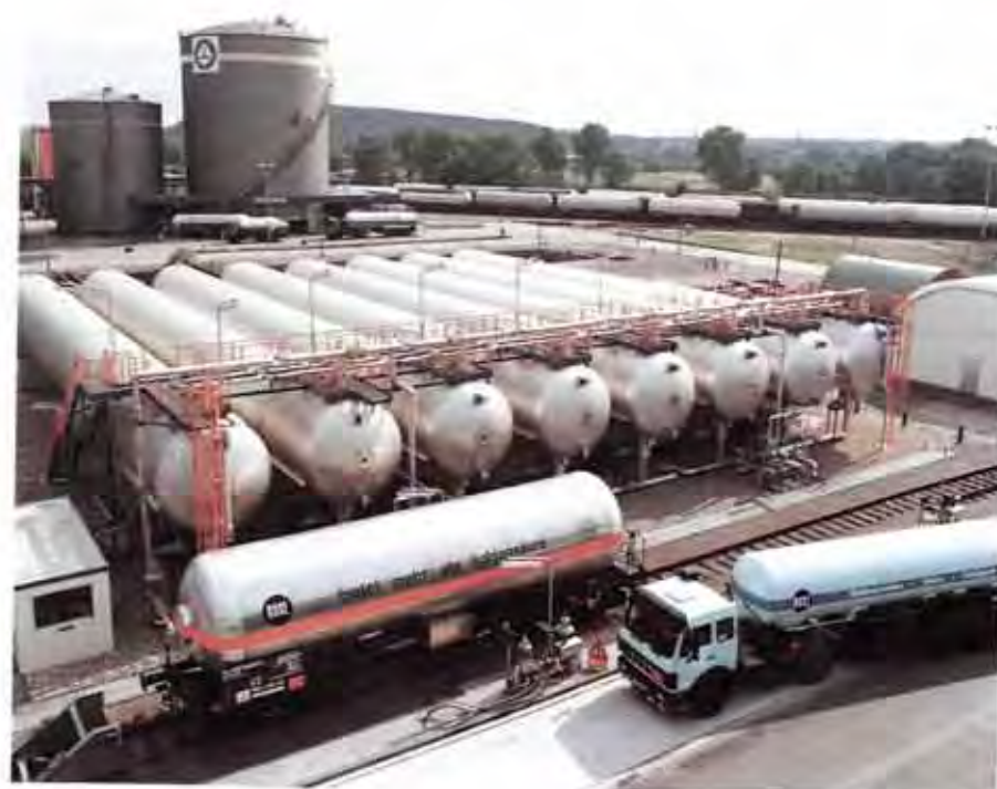
Beispiel für die Zusammenarbeit mit Buse ist ein Großtanklager für Kohlendioxid vor der Kälteanlage unserer Luftzerlegungsanlage in Oberhausen
