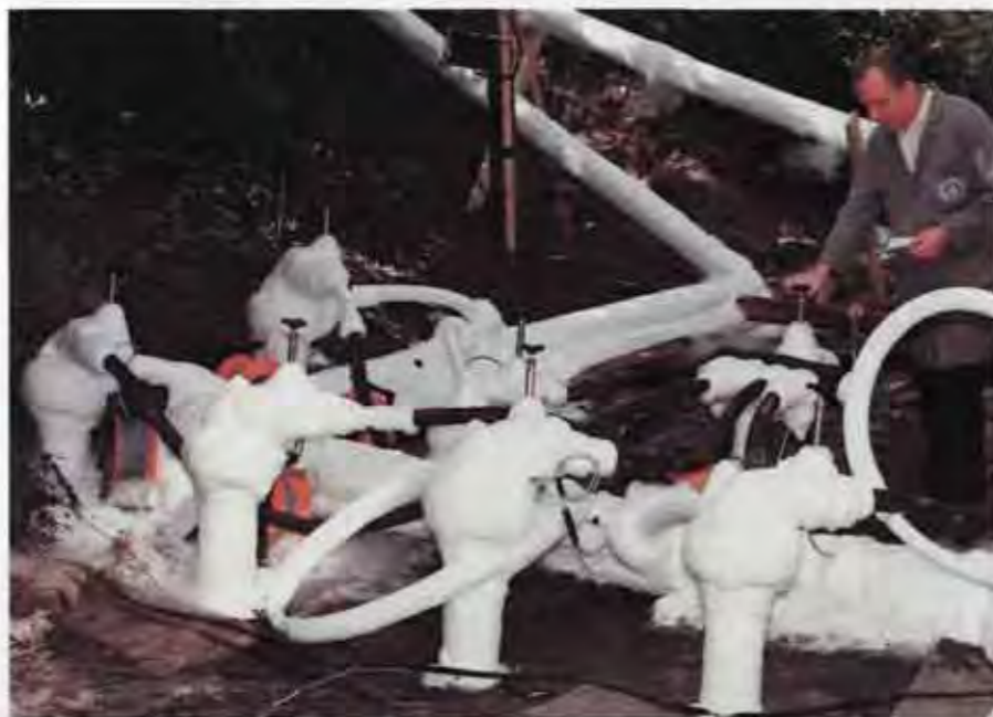
Über Gefrierlanzen wurde an der Stadtbahn-Baustelle in Gelsenkirchen flüssiger Stickstoff in das Erdreich eingebracht, um es für die Dauer der Reparaturarbeiten unter Tage zu verfestigen
