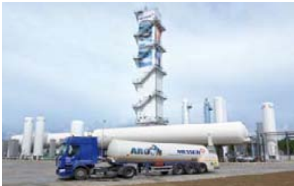
Sorgt für eine noch bessere Versorgung der Kunden: Neue Luftzerlegungsanlage in Resita, Rumänien
