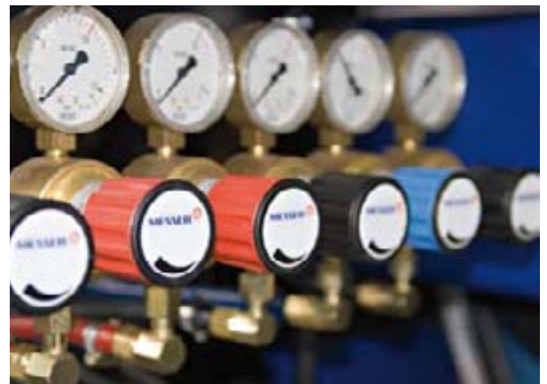
Entnahmestellen für technische Gase
