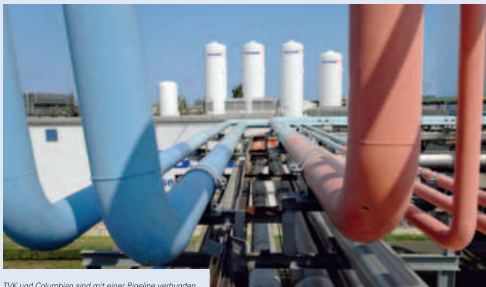
TVK und Columbian sind mit einer Pipeline verbunden.
