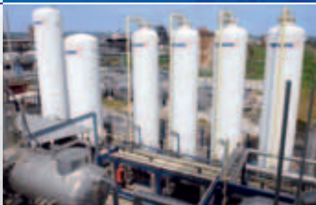
Produktionsanlage für Wasserstoff bei Huntsman in Ungarn
