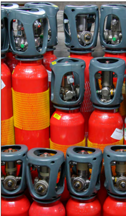
Gasflaschen werden korrekt stehend und mit dem Ventilschutz gelagert.
