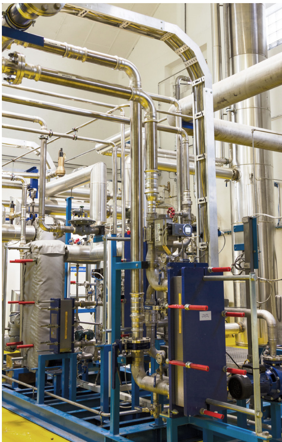
Die CO 2 -Rückgewinnungsanlage in Sulgen. (Bilder: zvg)
